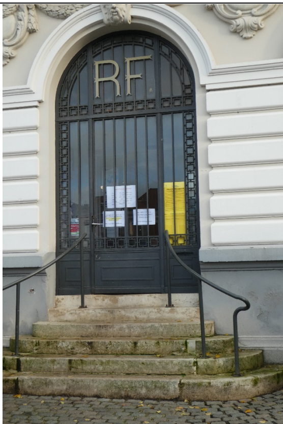
Affichage en mairie de Cysoing : 6 marches à gravir, non accessible PMR
