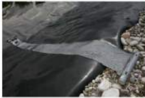
Echappatoire installé sur un bassin
