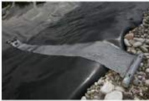
Echappatoire installé sur un bassin
